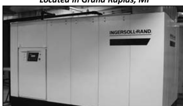
Ingersoll-Rand 250HP Air Compressor
